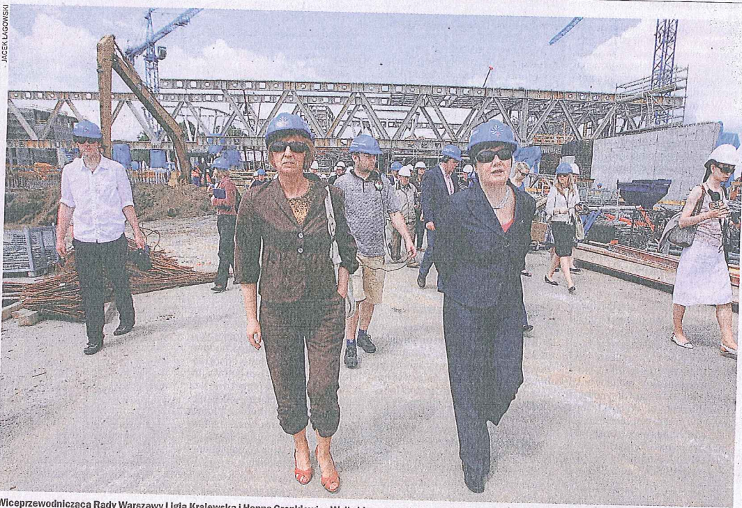
Wiceprzewodnicząca Rady Warszawy Ligia Krajewska i Hanna Gronkiewicz-Waltz idą po stropie tunelu Wisłostrady, nad którym montowane są kratownice Centrum Nauki „Kopernik”
